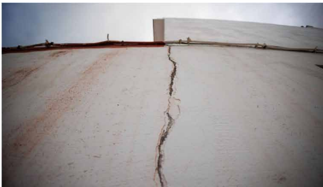
Grieta en la fachada de la casa de Milagri. MANU GARCÍA
